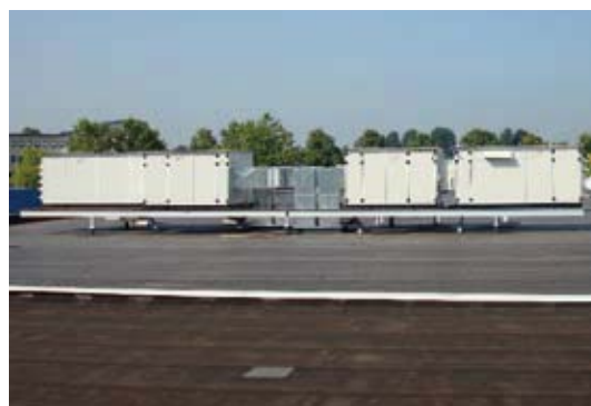
Luchtbehandelingsinstallatie bij SWB; voorzien van 2 StatiqCooling en WTW.
