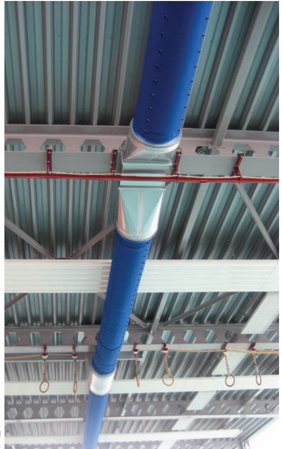
Foto 2. Flexibel luchtkanaal op zes meter hoogte onder het plafond voorzien van uitblaasnozzles.
